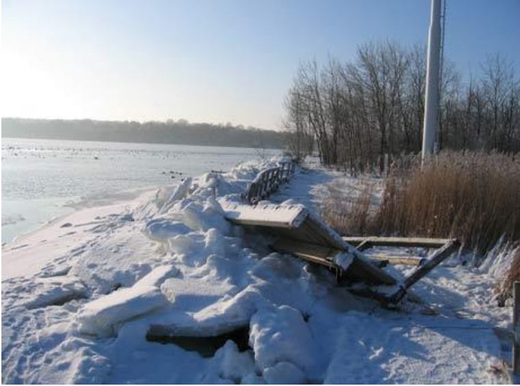
Die Brücke am südlichen Priwall-Wanderweg wurde vom Eis zerstört. Fotos: PL
